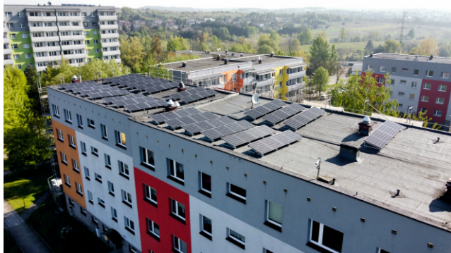
Wykonana instalacja fotowoltaiczna o mocy 23,66 kWp na dachu budynku przy ul. Skłodowskiej – Curie 103 przy wsparciu finansowym Banku Gospodarstwa Krajowego.
